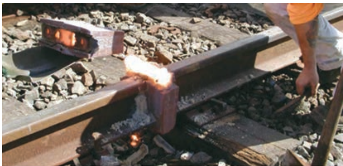
شکل ۲۷- شکستن قسمت فوقانی قالب
