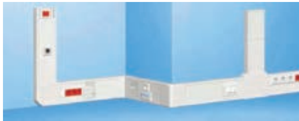
شکل ۸-۴ - نمونه‌ای از ترانکینگ نصب شده
