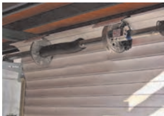
شکل ۱۱- محل نصب موتور کرکرهای
