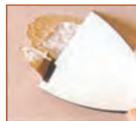
الف - باز کردن ترک‌ها
