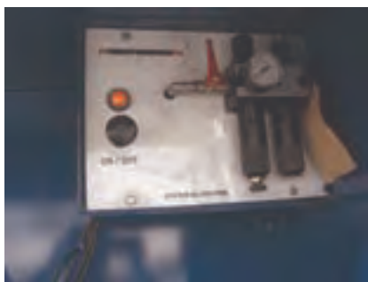
شکل ۴- تجهیزات اندازه‌گیری دما و فشار
