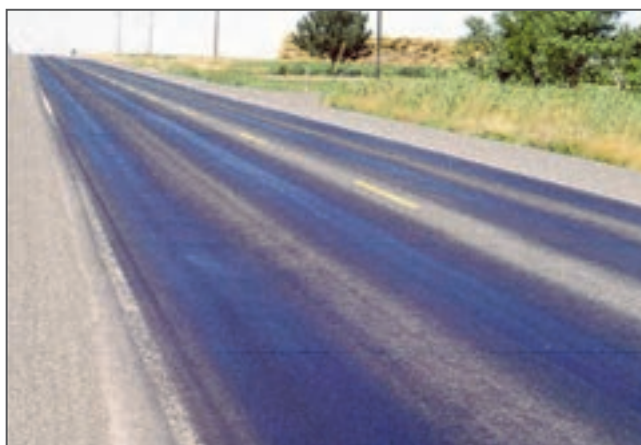
شکل ۵- قیرزدگی سطح روسازی آسفالتی
