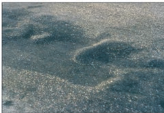
شکل ۳- تغییر شکل لغزشی سطح روسازی
