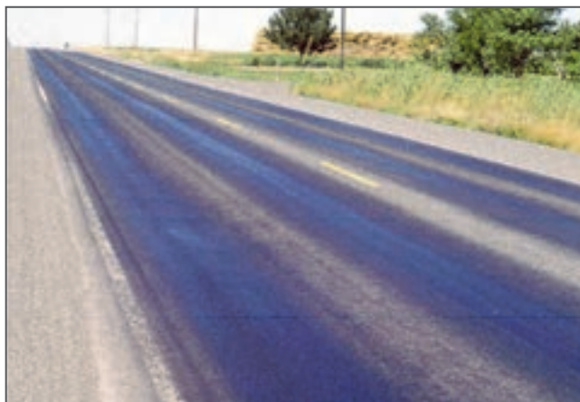
شکل ۵- قیرزدگی سطح روسازی آسفالتی
