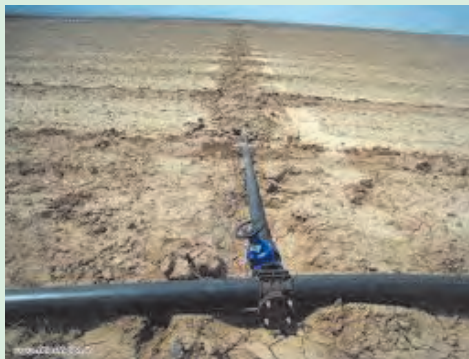
شکل ۴۶-۵. شیر فلکه لوله جانبی
