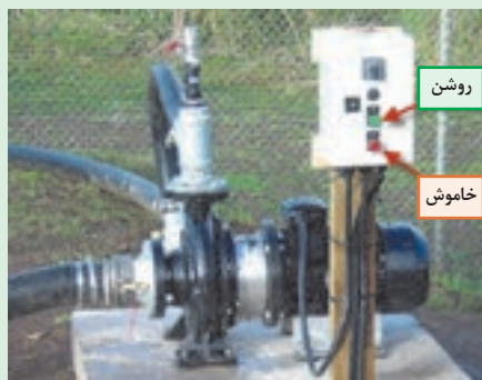
شکل ۲۸-۵. کلیدهای کنترل روی تابلو
