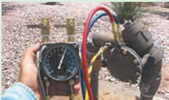
شکل ۳۱-۵. تنظیم فشار شیر فشار شکن
