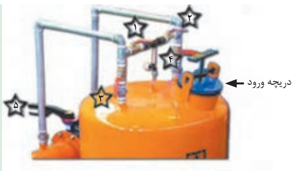
۱ و ۲- شیرهای برگشت (by pass)، ۳ و ۴- شیرهای ورودی و خروجی مخزن، ۵- شیر فلکه روی لوله اصلی
