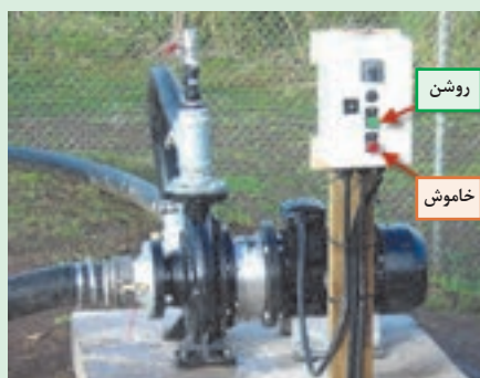
شکل ۲۸-۵. کلیدهای کنترل روی تابلو
