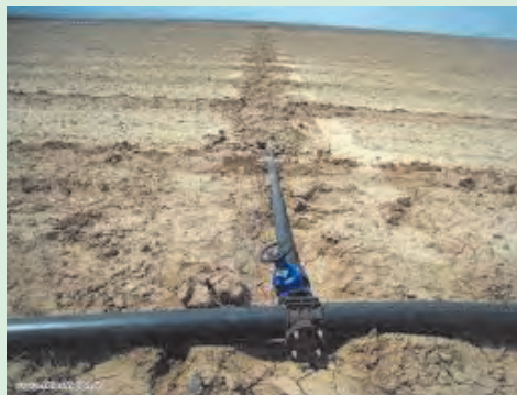
شکل ۴۶-۵. شیر فلکه لوله جانبی
