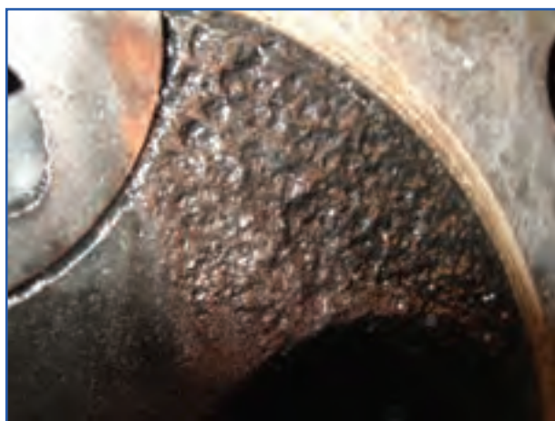
شکل ۲۷-۴- حفره‌های ایجاد شده بر اثر زنگ‌زدگی
