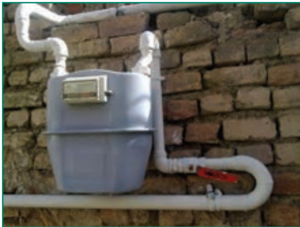
شکل ۸۱-۴ یک کنتور ۱۰ متری نصب شده
