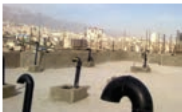
شکل ۲-۵۳ لوله‌های هواکش روی پشت‌بام
