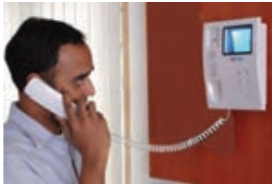
شکل ۸- نصب آیفون بالاتر از حد مجاز
