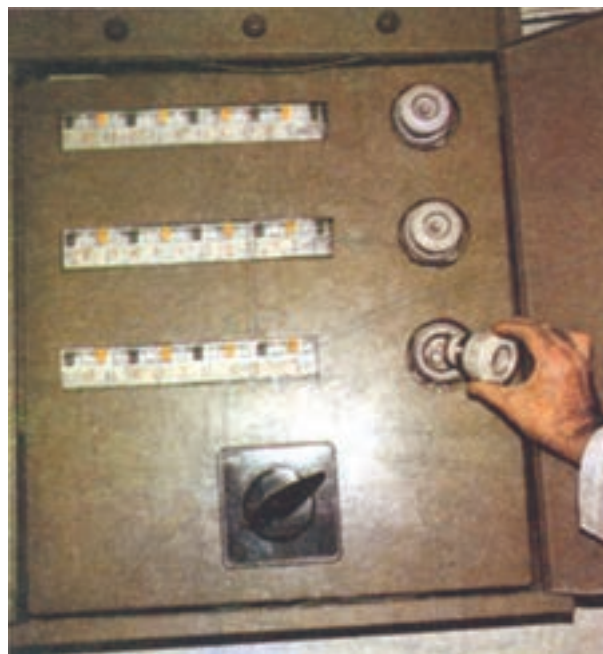
شکل ۲۸-۲- تابلوی برق توزیع داخلی و فیوزها و کلید قطع و وصل مربوطه
