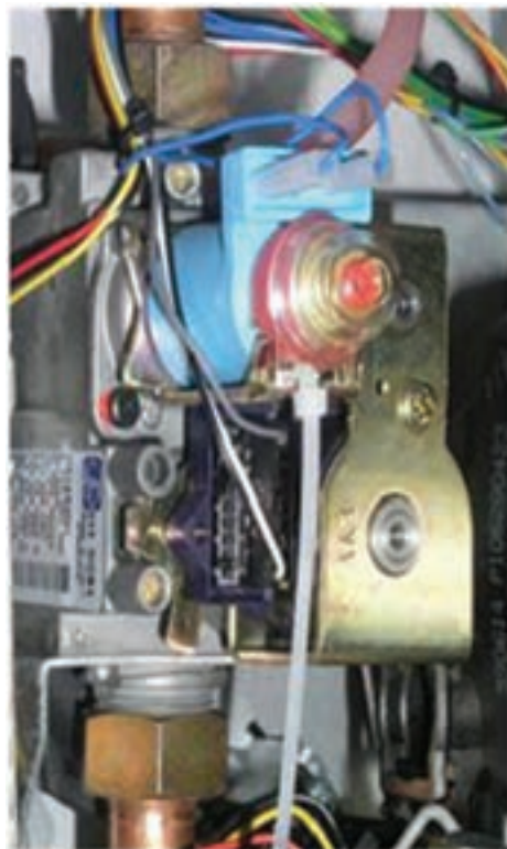
شکل ۱۴-۱۵- شیر کنترلر گاز
