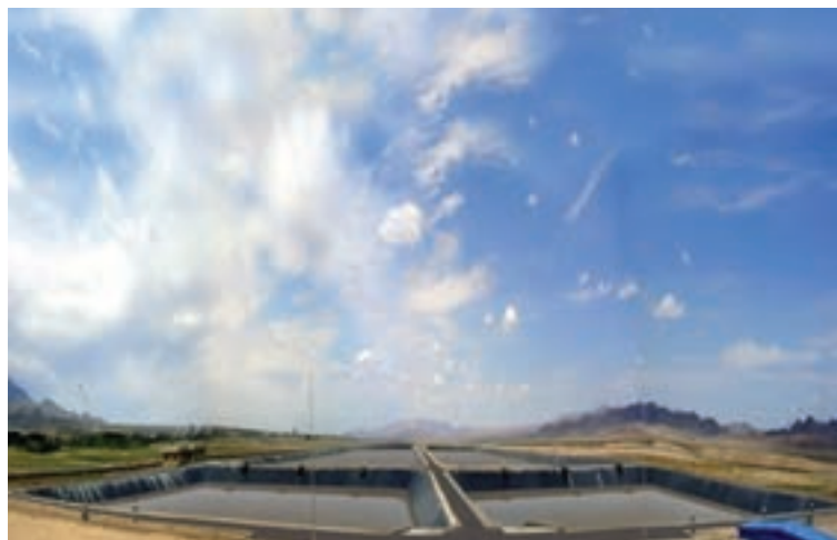
شکل ۱۶-۵- تصفیه‌خانه فاضلاب شهر بیرجند
