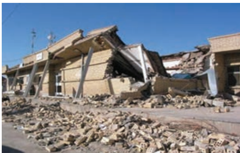
شکل ۱۲-۲- خسارات ناشی از زلزله در استان
