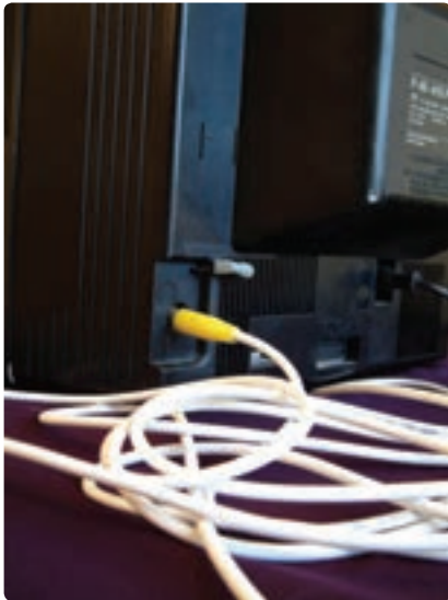
شکل ۴-۱۵- سیم کابل مناسب انتخاب نشده است.
