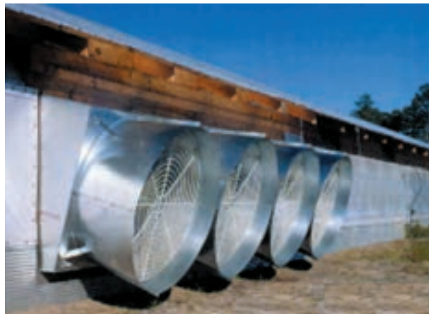
نمای هواکشها از بیرون جایگاه
