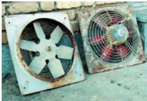
تعویض هواکشهای خراب و فرسوده
