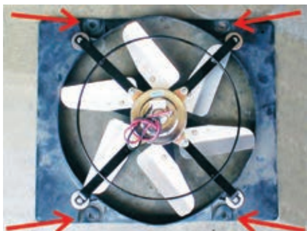
شکل ۱۷-۶- فن خنک کاری پس از پیاده کردن آن
