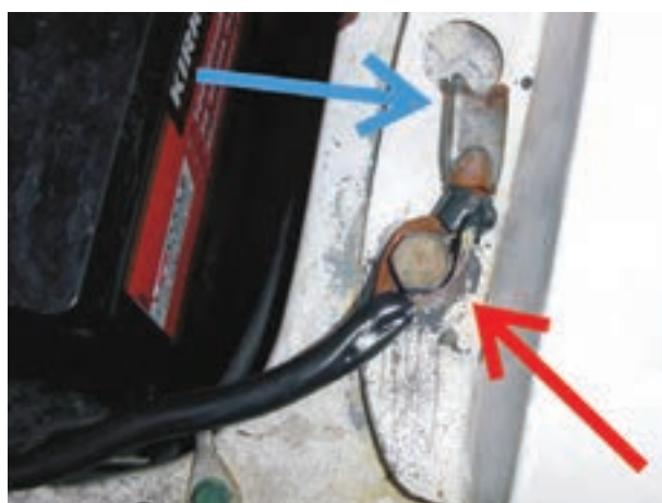
شکل ۳۷-۲- اتصال غلط کابل باتری به بدنه
