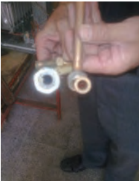
شکل ۱۲-۵- تشکیل رسوب در لوله آب گرم
