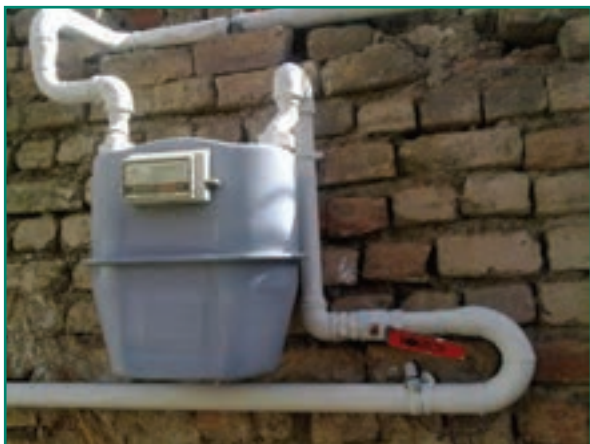
شکل ۸۱-۴ یک کنتور ۱۰ متری نصب شده
