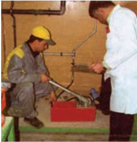
شکل ۵-۹۳- نحوه‌ی آزمایش با پمپ آزمایش دستی
