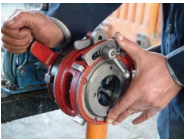
شکل ۱۱۴-۴- سفت کردن فلکه‌ی چهار نظام
