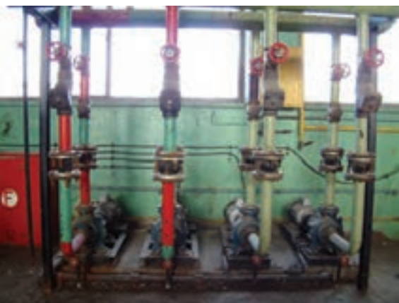
شکل ۳-۵- کاربرد لوله درزدار در لوله‌کشی شوفاز
