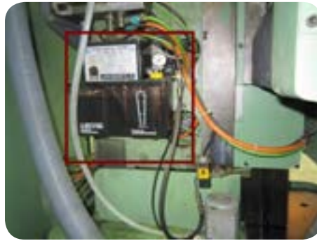
مکان نصب مخزن واحد مرکزی
