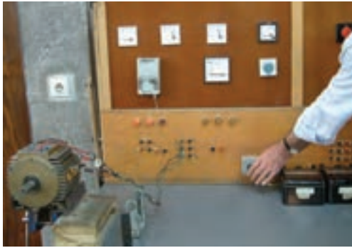
شکل ۹-۶- اتصال موتور به تابلوی برق
