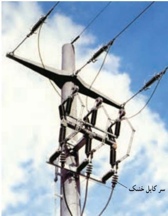
شکل ۶-۶- سر کابل خشک حرارتی هوایی
