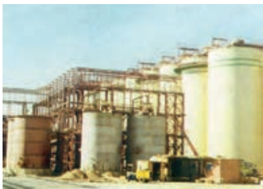
شکل ۱-۳۹- تأسیسات نفتی در جنوب
