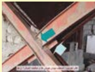
ضعیف بودن جوش و عدم اتصال مناسب
