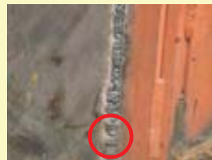
عدم جوش پیوسته - لوچه
