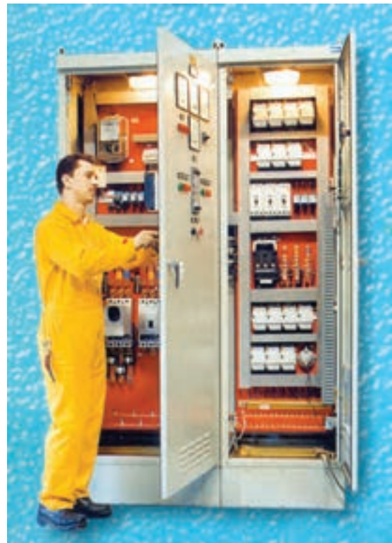
شکل ۹-۲- نمونه‌ای از تابلو توزیع برق
