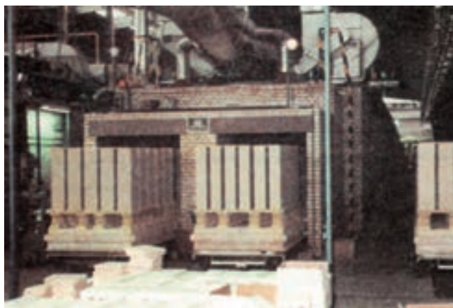
شکل ۴-۵- خشک‌کن تونلی دو قلو برای خشک‌کردن کاشی
