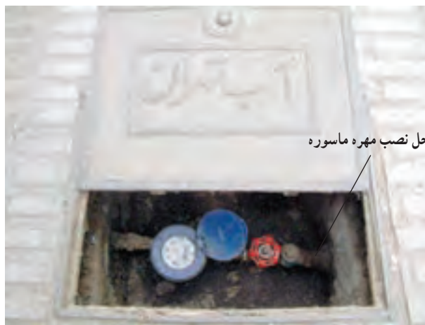
یکی از موارد استفاده مهره ماسوره در لوله کشی آب سرد و آب گرم
