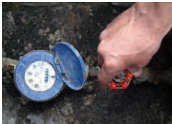
۱- بستن شیر اصلی بعد از کنترل آب
