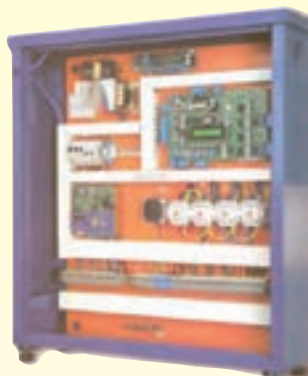
تابلو اصلی برق اضطراری آسانسور
