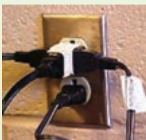
شکل ۲۳-۲- انشعاب غیر استاندارد از پریز برق
