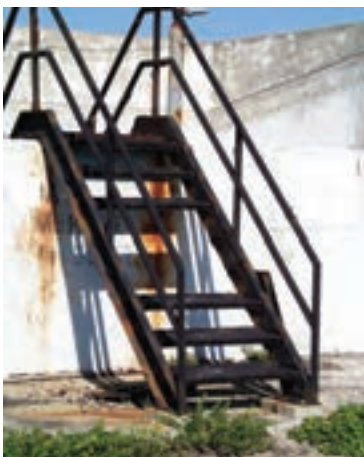
شکل ۷-۲- نردبان فلزی در شرایط حیاط خانه دچار خوردگی شده است.
