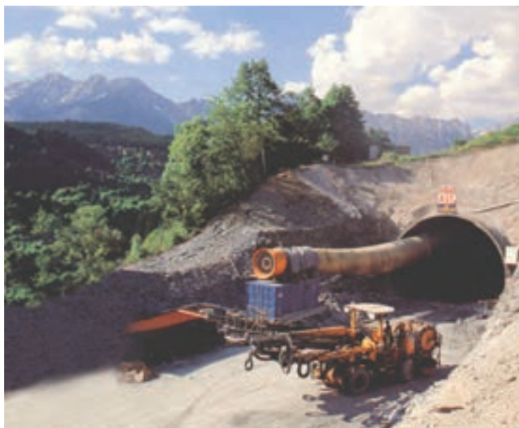
۱۴-۹- لوله‌های فلزی تهویه با اتصال جوشکاری شده
