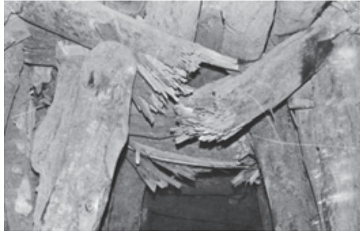
شکل ۱۹-۲۴- شکسته شدن چوب بست در اثر فشار طبقات
