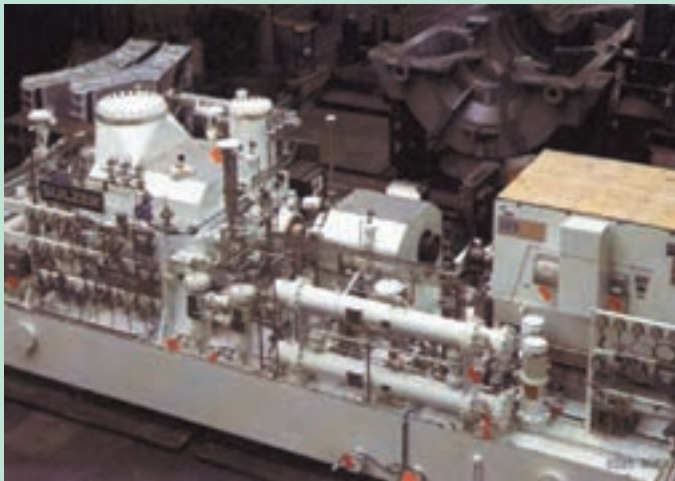
شکل ۷-۵-ج - کمپرسور استفاده شده در سیستم سردسازی
