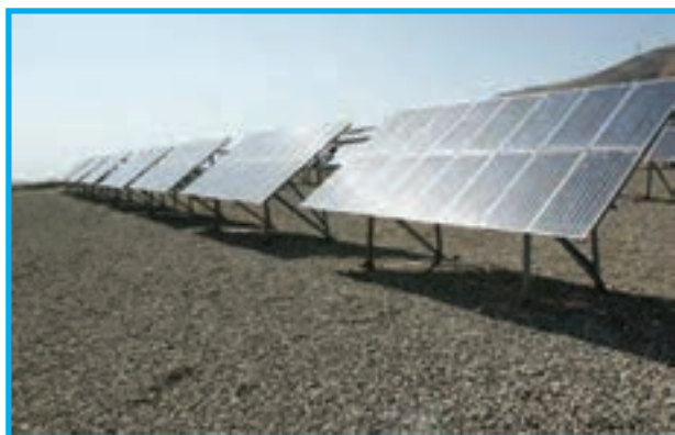
شکل ۱۰-۳ یک نیروگاه فتوولتاییک
