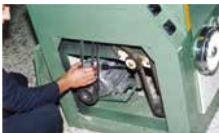
شکل ۲۶-۷- کنترل سفتی تسمه‌ی انتقال نیرو.
