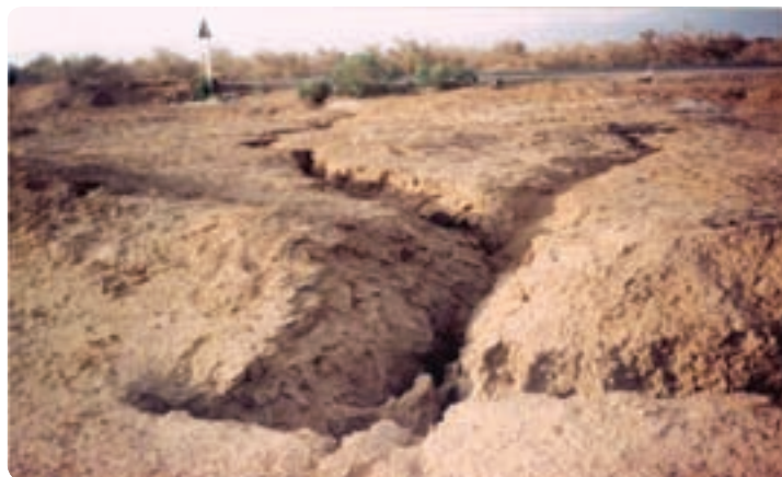
شکل ۶۰-۱- پدیده فرونشست در منطقه رضوان شهر
