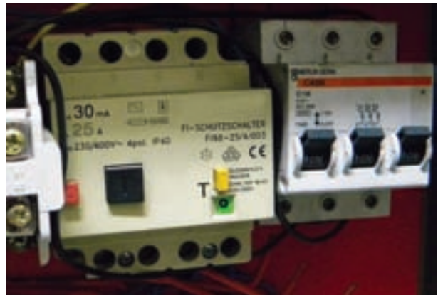
شکل ۱-۴- فیوز حفاظتی نصب شده در کارگاه
