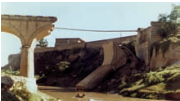
شکل ۱۷-۶- تخریب یک پل ارتباطی بر اثر سیل
