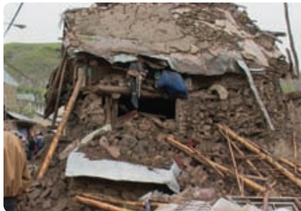
شکل ۲-۵- زلزله سال ۱۳۸۳ - طالقان
