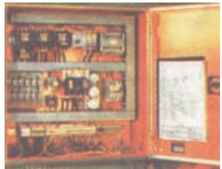
شکل ۲-۵۵ جعبه فرمان الکتریکی (راه اندازی و توقف قسمت های مختلف دستگاه با استفاده از پدال های مربوطه)
