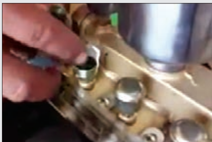
شکل ۵۴- در گریس کاری پمپ پیستونی
