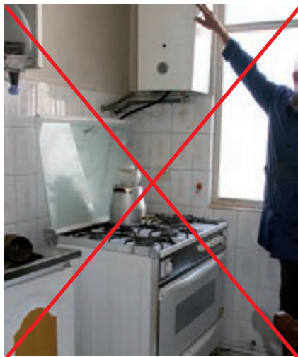
شکل ۱-۶ نصب نادرست آب گرم کن.
