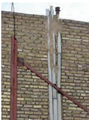
شکل ۴-۶ الف دودکش نادرست
