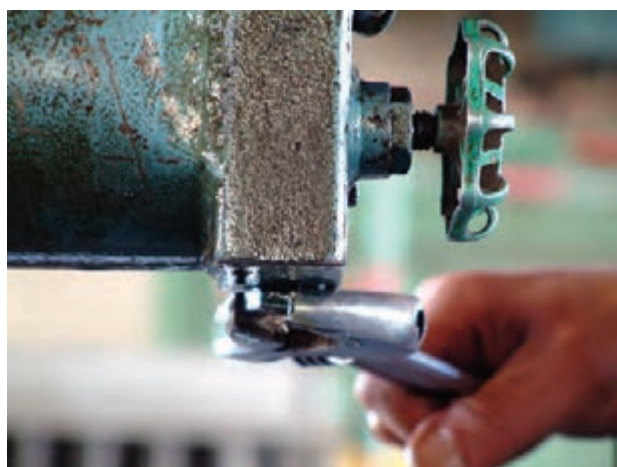
شکل ۱۴-۳ باز کردن درپوش تخلیه ی روغن
