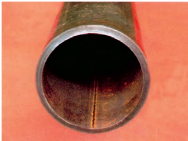
شکل ۲-۱۳- لوله‌ی برق خورده
