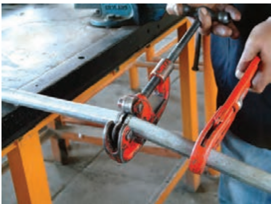
شکل ۱۱۷-۵- بریده شدن لوله و خاتمی کار
