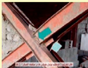
ضعیف بودن جوش و عدم اتصال مناسب
